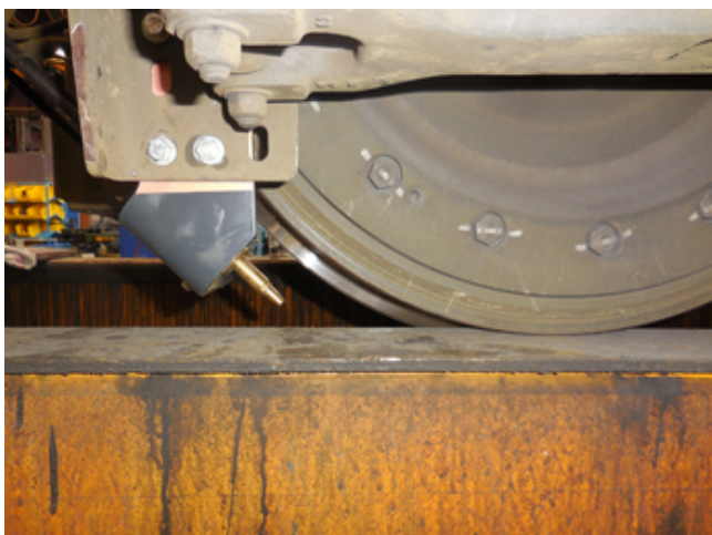
Bild: eine Düse appliziert eine Dosis vom Schmierstoff. Eine diskrete, aber anscheinend effiziente Installation.
