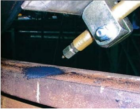
Abb. 2: Position der Schienenkopfdüse mit Sprühbild.
