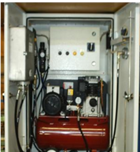
Kompressor mit Steuerung
